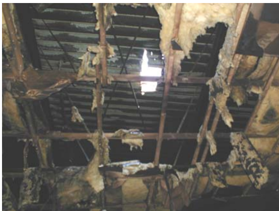
Abb. 10: Von innen sichtbare Dachöffnung, mit Resten der abgehängten Decke [1]
