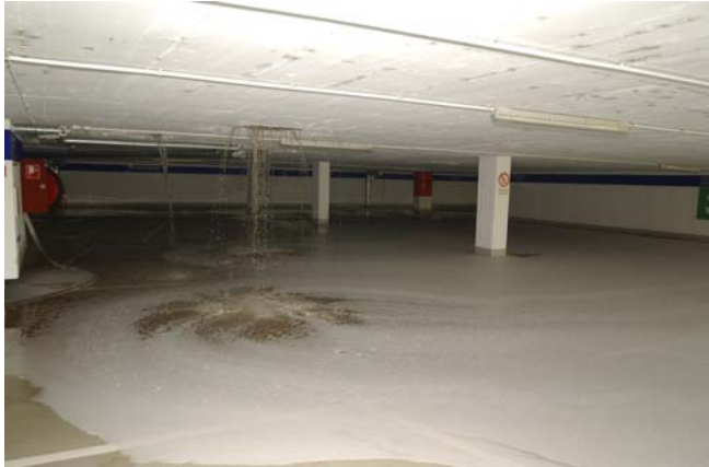
Abb. 14: Wasseraustritt im Bereich der Decke der 3. Parkebene [1]
